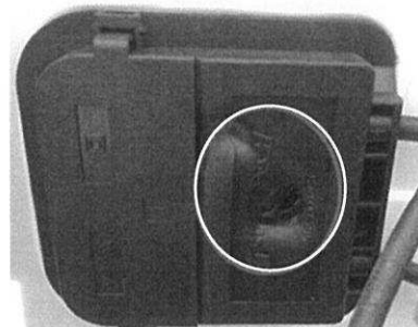
写真2 変形したジャンクションボックス
