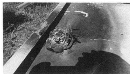
写真4 焼損したジャンクションボックス
