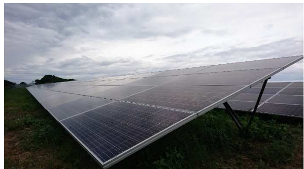
曇天の低照度の条件下で直流側の点検作業を実施
