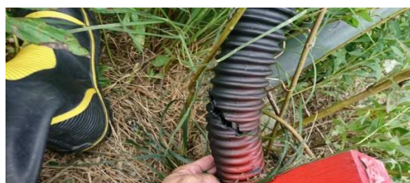
草刈機によるケーブルダクトの破損箇所
